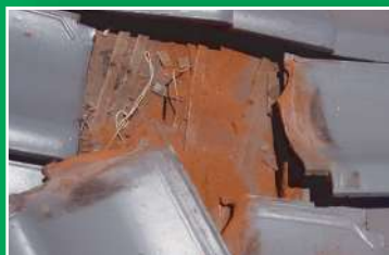
塩害に侵された他産地瓦
